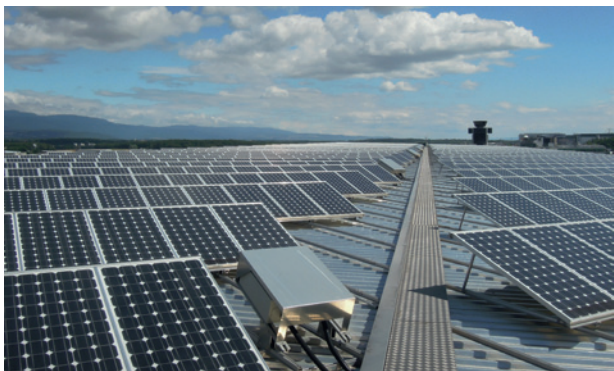
280 kW-Anlage Grand Hangar in Genf
